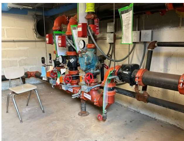
29 - FIRE SPRINKLER RISERS
